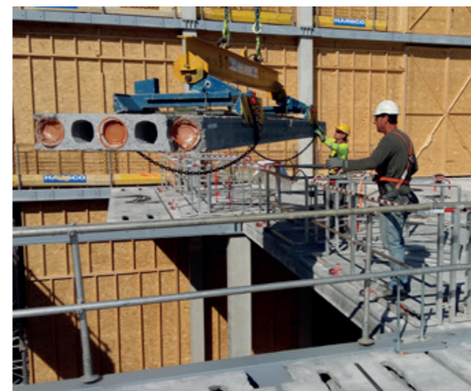
De eerste toepassing van het, in eigen beheer ontwikkelde, belt-free systeem voor het veilig monteren van kanaalplaatvloeren.
